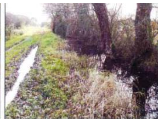
Chemin communal et fossés en amont immédiat de la jonchaie. Le positionnement sur un point bas et le mauvais profilage des fossés contribuent à l'état de délabrement du chemin.
